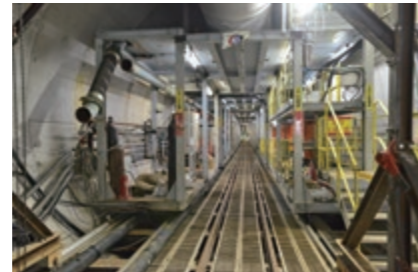
シールド内設備
