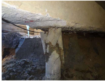
図2 東日本大震災で損傷した杭（国交省発表資料 2) より引用）
