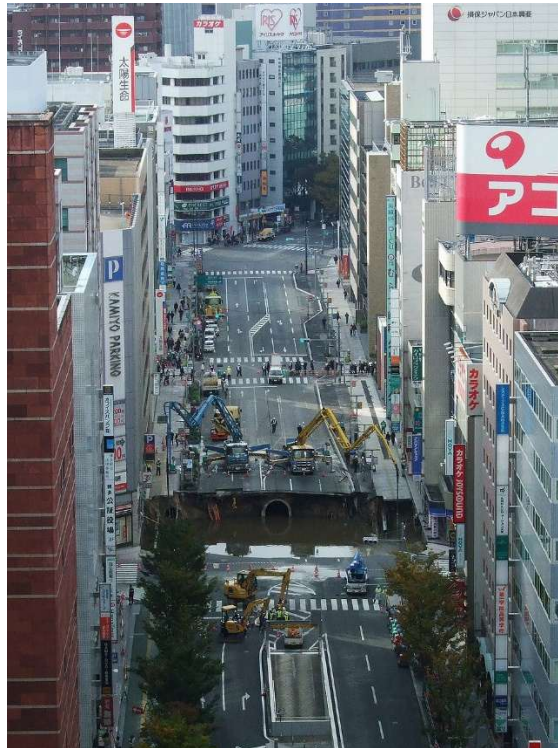
図1 参考：博多駅前道路陥没事故の様子
