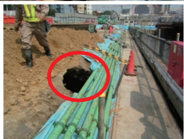
土砂流出による地盤陥没の例
